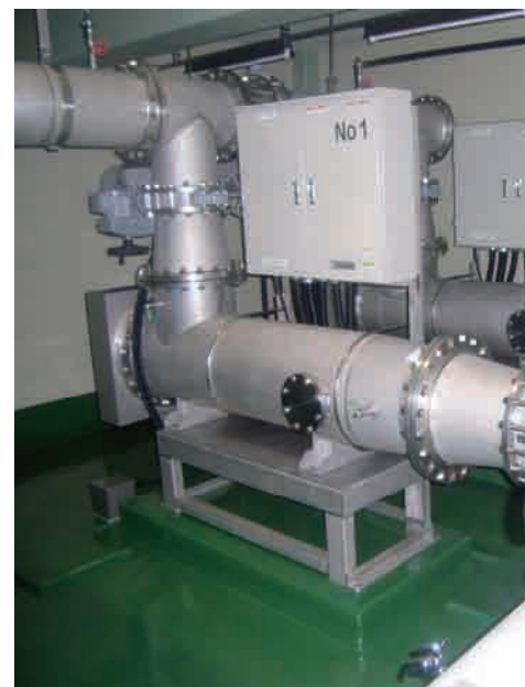
下湯配水池紫外線処理設備室
