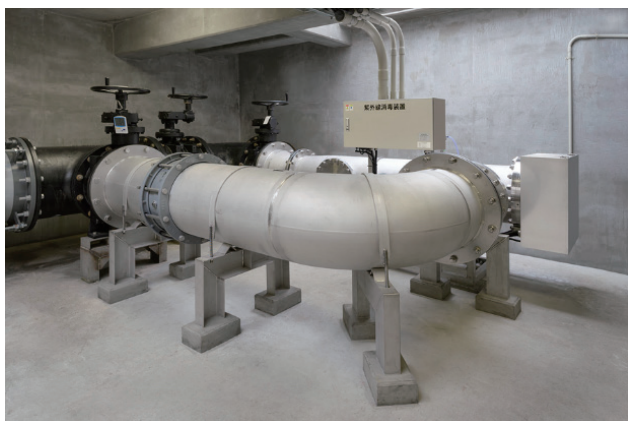
図4 更新後の紫外線照射装置（H31.2 完成）
